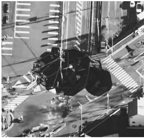
昨年1月に発生した八潮市道路陥没事故の現場
